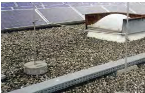
Zdjęcie nr 2 Prawidłowe skrzyżowanie instalacji PV i odgromowej na dachu
