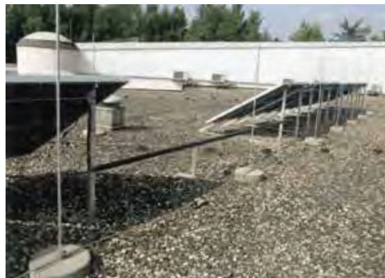
Zdjęcie nr 3 Prawidłowe ułożenie równoległe instalacji PV i odgromowej na dachu
