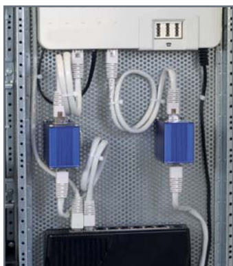
Ochrona urządzeń Ethernet
